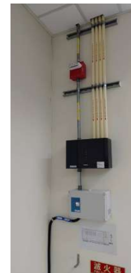
▲ 資訊安全 - 計中 - 極早期火災預警系統
