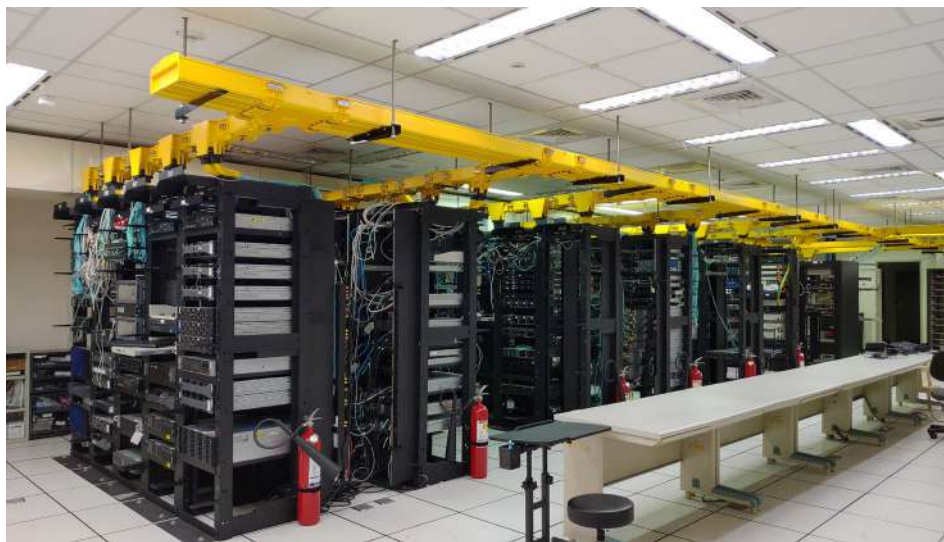
▲ 資訊安全 - 計中 - 機房
